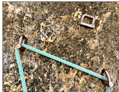
Figura 8: Grampo 'P' corroído e danificado para evitar seu uso. Data da manutenção desconhecida. Local: via Reinaldo Behnken , 1984, Urca, Rio de Janeiro, Brasil. Foto do autor setembro de 2024.
