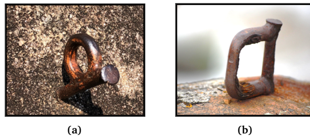
Figura 6: Exemplos de uma região litorânea no Rio de Janeiro. a) Grampo 'P' em perfeito estado, com pátina e estabilidade à oxidação, instalado em rocha sem vegetação, face norte, no Parque Nacional da Tijuca (altura 850m), foto de julho de 2024. b) Grampo 'P' deteriorado por corrosão, em rocha litorânea na Prainha, Rio de Janeiro, foto de outubro de 2009.
