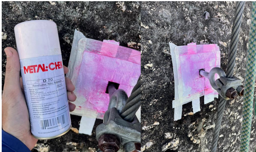
Figura 6 - Etapa final de revelação do ensaio de líquido penetrante em ancoragem similar.
